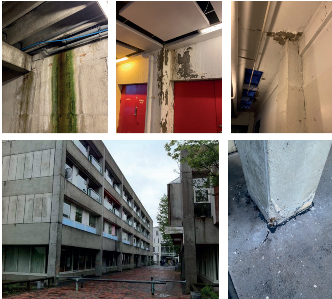
Eksempler på tilstanden af bygningernes facader, konstruktion og installationer, 2021.
