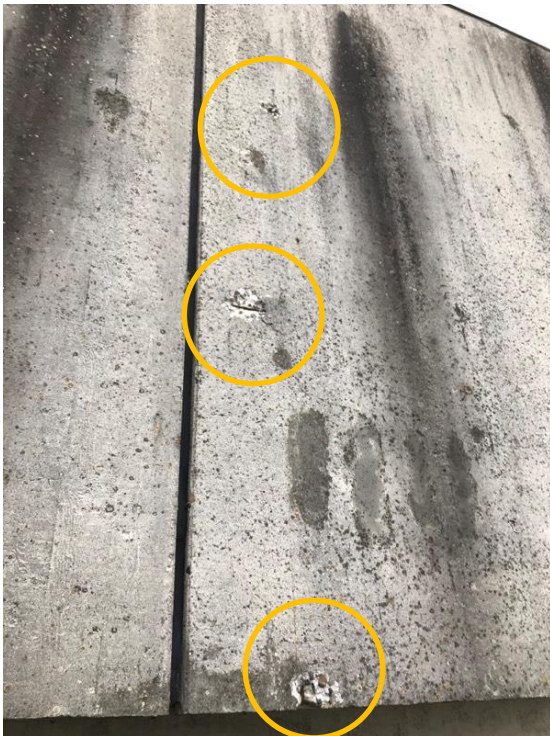
Herover ses eksempler på afskallende beton og korrosion på armering i facaderne.
