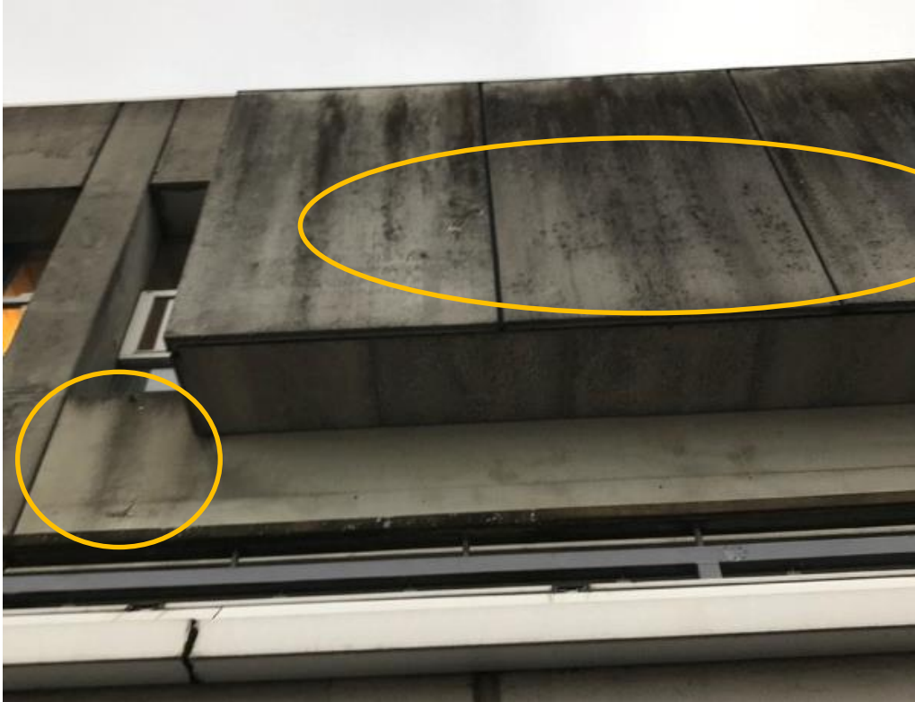
Herover ses eksempler på afskallende beton pga. korrosion i armering.
